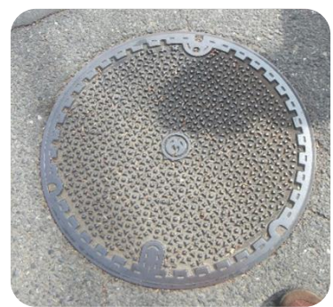
スリップ止めのマンホール
